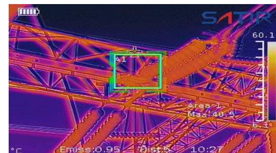
Gambar 3. hasil thermovisi sebelum perbaikan fasa S
